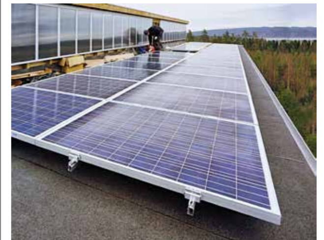
Solvarmeanlegg på vegg, solcelleanlegg på tak.
